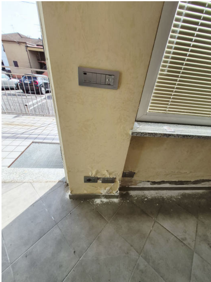
09 - Problematiche di umidità di risalita
